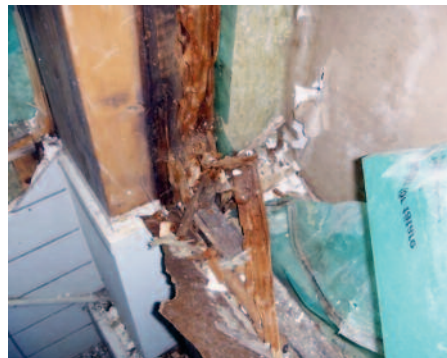
Exempel på fuktskada simhall.
