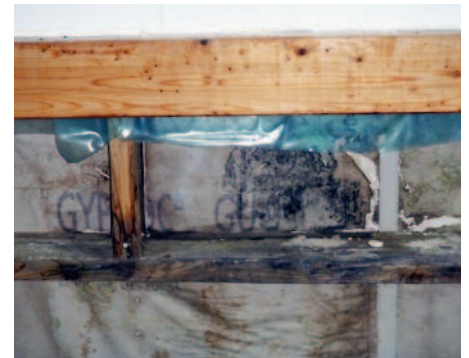
Exempel på fuktskada simhall.
