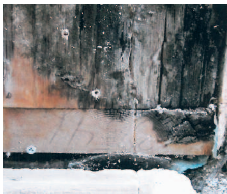
Bild 1: Fukt- och mögelskadad syll och väggregel.
