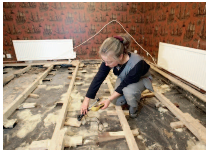
Fuktskada, platta på mark med uppreglat trägolv.
