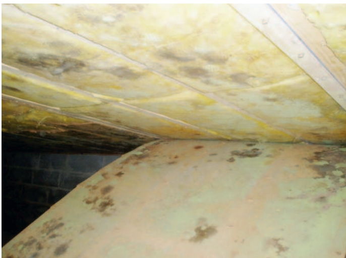
Fuktskador i uteluftventilerad krypgrund.
