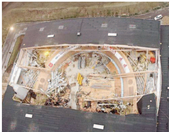
Skadefall 2: Den kollapsade cykelvelodromen i danska Ballerup.
