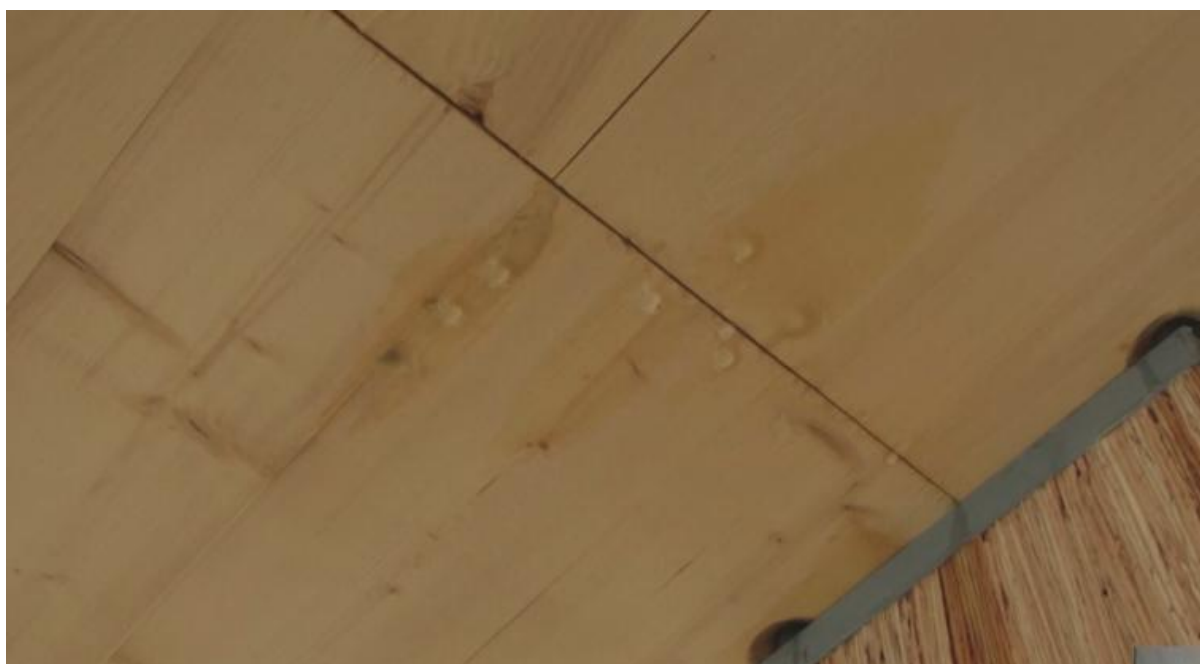
Figur 4: Bild på fritt vatten som passerar igenom en skarv i KL-träbjälklag under uppbyggnad [5].
