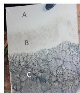
Figur 6: Bild på vattenskadad gips.
