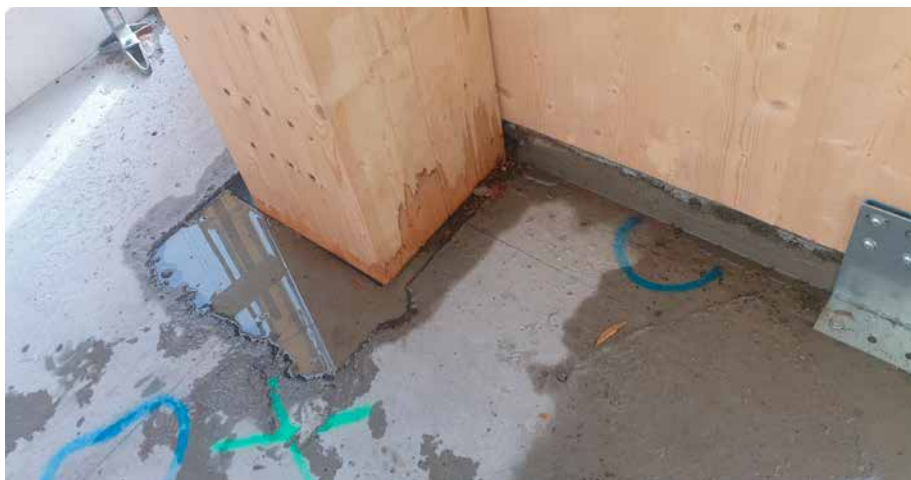
Bild 6. Väggar av KL-trä som pallats upp för att undvika kontakt med regn och blötsnö på betongplattan (t.h.) ihopmonterad med en limträpelare som inte pallats upp och därav står ner med ändträet i fritt vatten som sugts upp i pelaren (t.v.).
