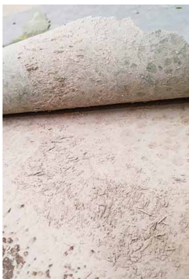
Figur 17. Dålig vidhäftning vid pulveriserad avjämningsyta under tätskiktet.
